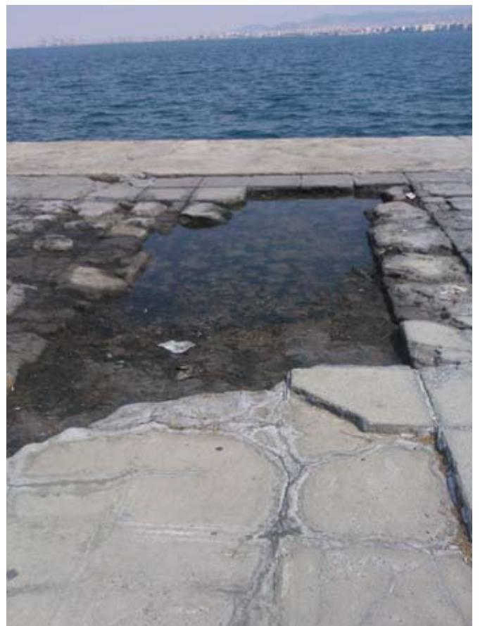
Τα πλακάκια σε πολλά σημεία είναι κατεστραμμένα ενώ οι πεζόδρομοι έχουν λακκούβες!
